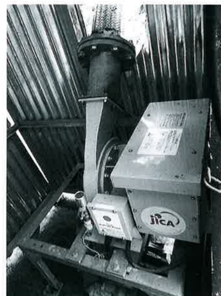
タマラウ滝に設置した飲料水システム
