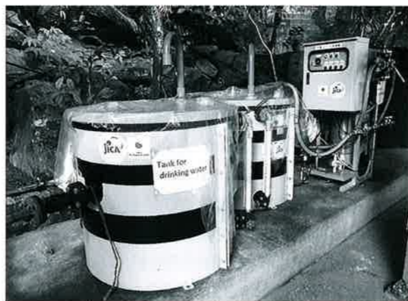
小水力発電機
