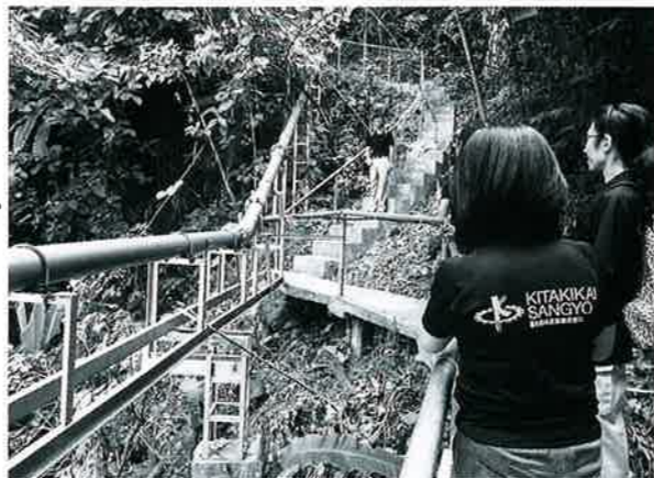
滝からの送水管と喜多機械産業のスタッフ
